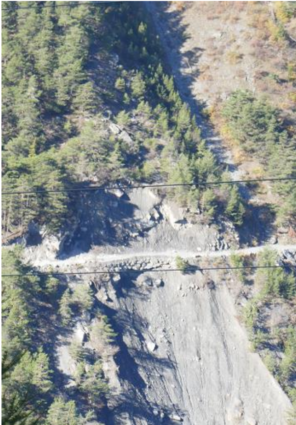
Avant travaux : affouillement sous les enrochements
